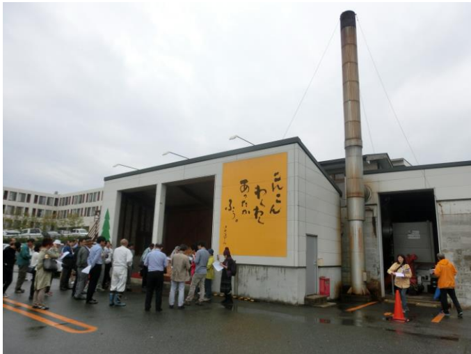
チップボイラー設備
